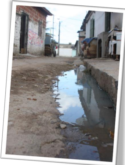
Figura 5 Falta de manutenção afetando o sistema condominial, Mustardinha, Recife, Brasil
